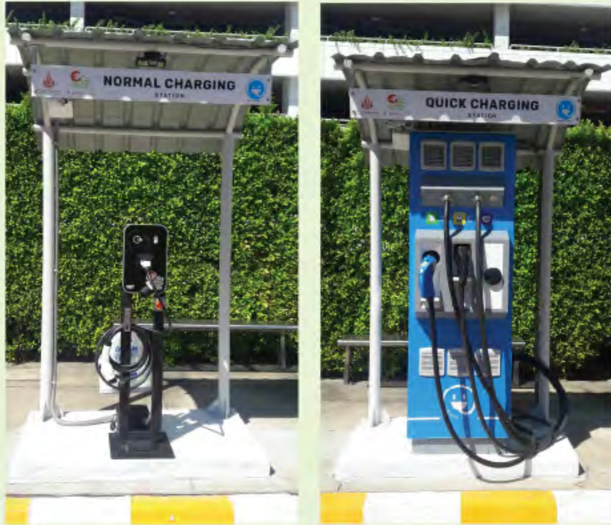
ตัวอย่างสถานีอัดประจุไฟฟ้าในโครงการฯ ณ สำนักงานปลัดกระทรวงพลังงาน
